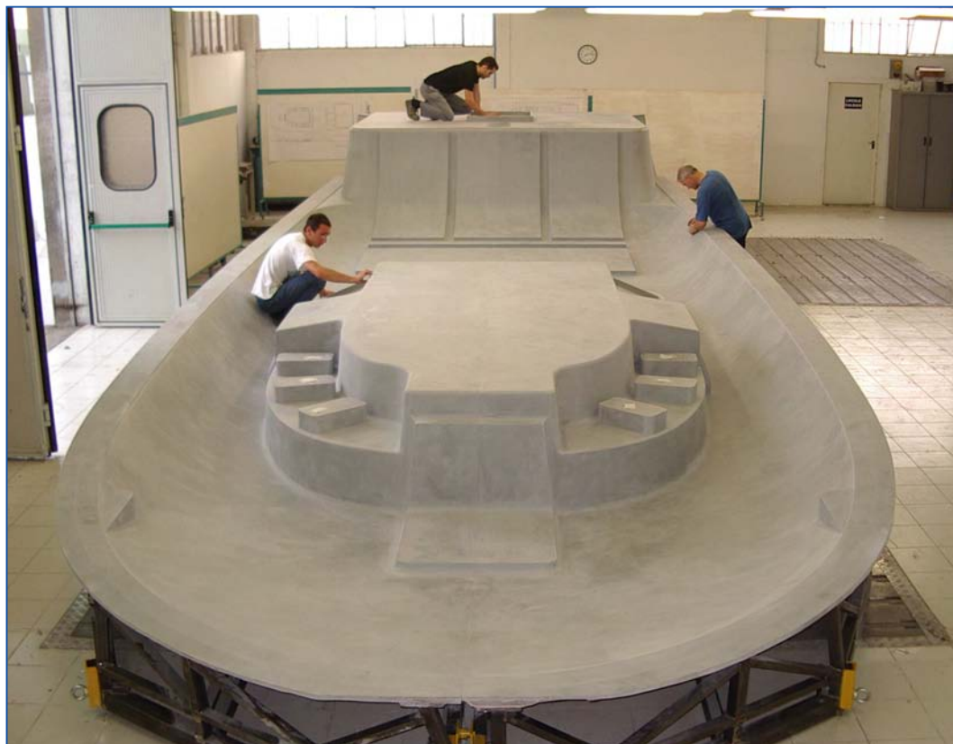
[Fig. 3] La preforma terminata sul suo basamento / The Mould on its Basement
