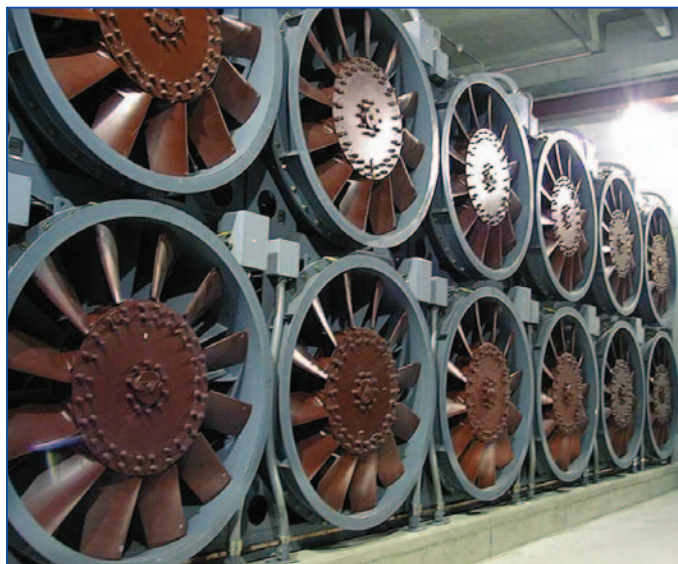
[Fig. 4] - I ventilatori della galleria / The wind tunnel fans
